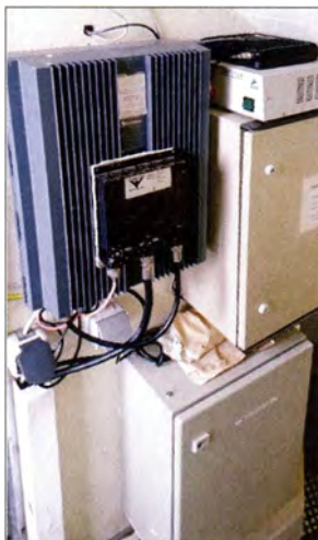
Die Möglichkeiten für die Installation von umfangreicher Systemtechnik sind auf dem Astenturm begrenzt. Das Bild zeigt den Aufbau des Relais im Treppenaufgang (Stornorelaisgehäuse und GM-900 Link-RX).
