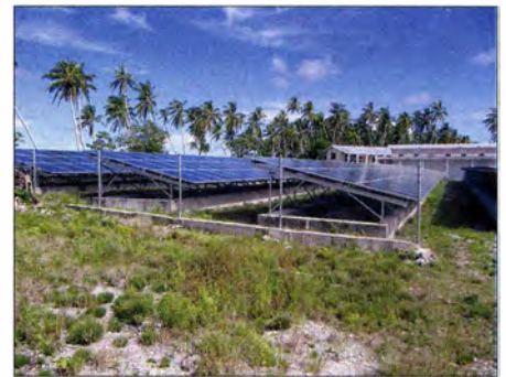
Die Photovoltaik-Anlage mit 1400 Zellen
