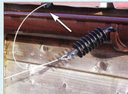
Bild 12: Eindraht-Zuleitung der Empfangsantenne in den Geräteschuppen zum Unun
